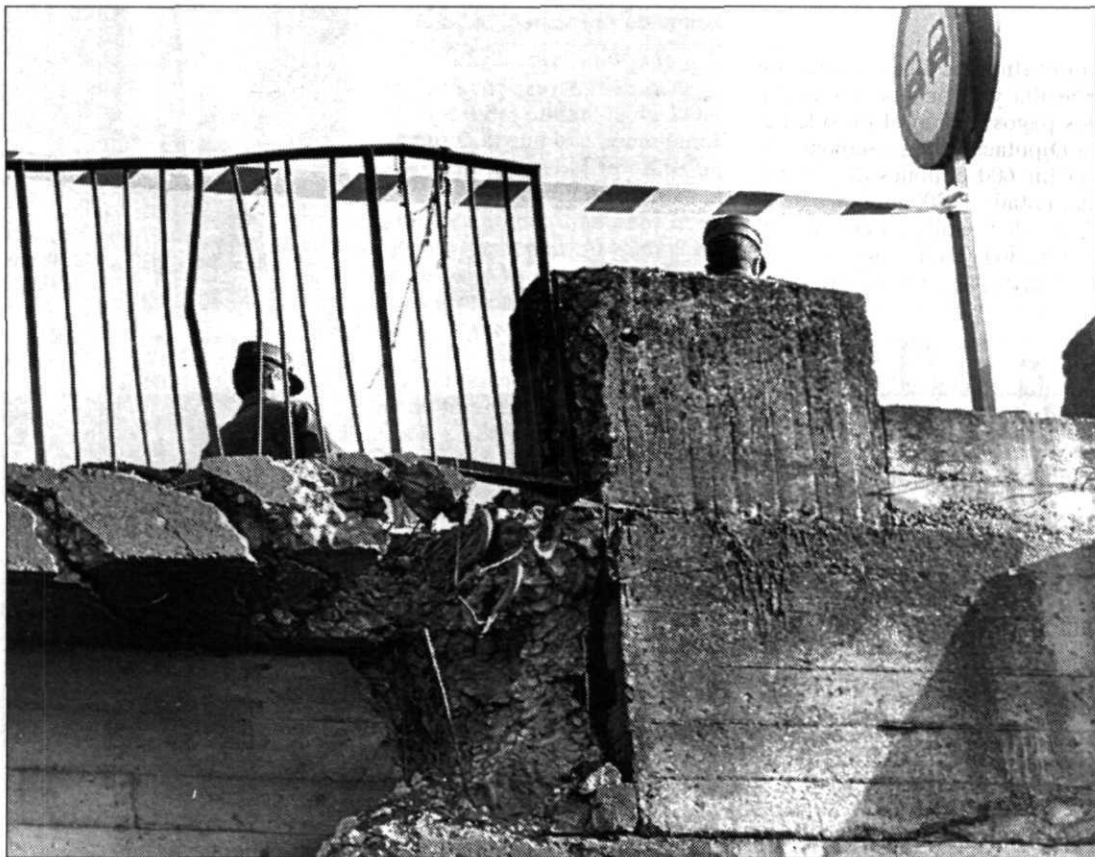
Aspecto que presentaba el puente después de la explosión. FOTO EFE
