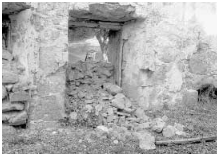
Hueco abierto en la ventana de la Casa de la Moneda. / RAÚL VILLAS
